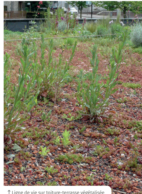
↑ Ligne de vie sur toiture-terrasse végétalisée
