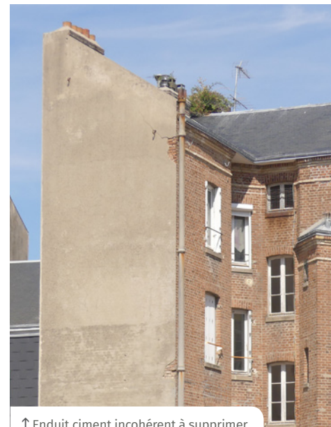
↑ Enduit ciment incohérent à supprimer
