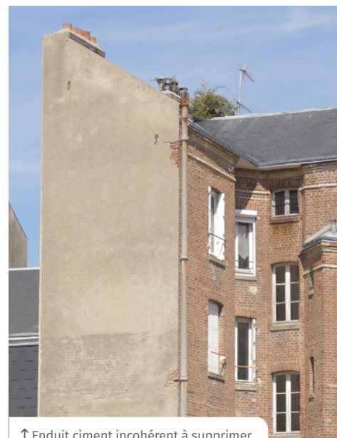
↑ Enduit ciment incohérent à supprimer
