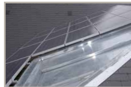
⬇ Photovoltaïque, Ener-tech, installateur
