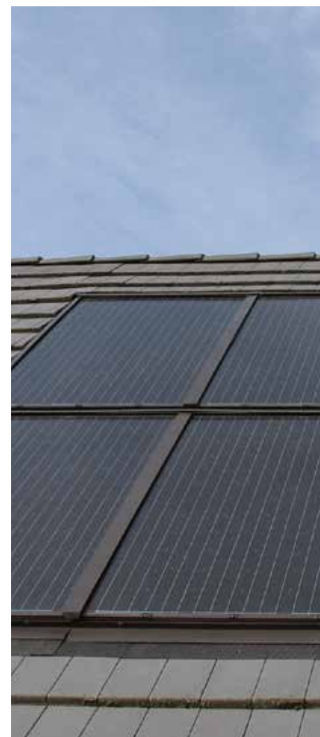
▲ Photovoltaïque, Solariis installateur
